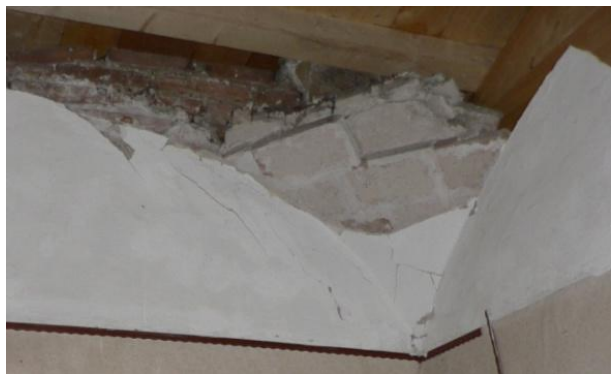
Figura 10. Esempio di crollo di volta in foglio.
