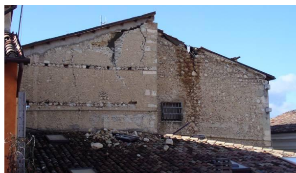
Figura 8. Ribaltamento della parete libera in direzione trasversale dell'Unità 5a.
