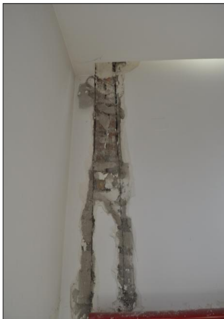
Figura 7. Danneggiamenti in corrispondenza di uno dei giunti, per effetto del martellamento tra un vano scala e l'edificio attiguo. Si noti il giunto saturato da materiale murario.
