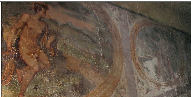
Foto degli affreschi, presenti all'interno dell'edificio, danneggiati dal sisma del 2009
