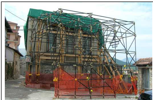
Foto dell'esterno dell'edificio danneggiato dal sisma del 2009
