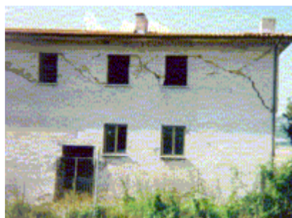
Fig. A4.11 - Lesioni diagonali dei maschi murari del secondo piano (tipo 3) collegate a lesioni orizzontali (tipo 1); verso destra si nota la formazione di un grosso cuneo di muratura dislocata di oltre 10 cm. Livello del danno: D4.
