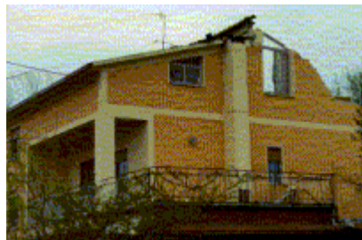
Fig. A4.28 - Crollo parziale di una copertura in travetti di c.a. e tavelloni senza caldana. Livello del danno alla copertura: D4-D5
