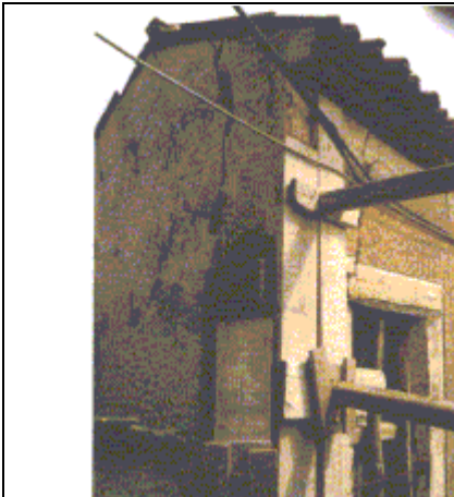
Fig. A4.15 - Lesioni verticali da distacco (tipo 7) su due pareti ortogonali, con distacco completo di un cantonale. Livello del danno: D3 tendente a D4 (Rivello, PZ, 1998)
