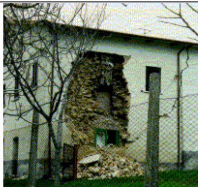
Fig. A4.17 - Crollo parziale di muratura a sacco in corrispondenza di vecchie aperture, per distacco esteso del paramento esterno (tipo 12); a destra si sviluppa una grave lesione diagonale (tipo 3) con dislocazione di diversi cm di buona parte della parete. Livello del danno: D4 (Busche, PG, 1996)
