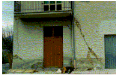
Fig. A4.23 - A sinistra lesioni verticali da distacco (tipo 7); lesione diagonale (tipo 3) sul maschio tra le due porte. La muratura è in blocchi di tufo. Livello del danno alla parete: D3
