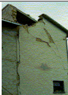
Fig. A4.9 - Lesioni verticali con distacco dall'edificio adiacente (tipo 7); lesioni diagonali (tipo 3) ed orizzontali al livello del solaio (tipo 11); crollo parziale della copertura e delle murature di appoggio della copertura. Livello del danno: D2-D3 alle strutture verticali dei piani inferiori; D4-D5 alle pareti superiori e alla copertura (Busche, PG, 1998)
