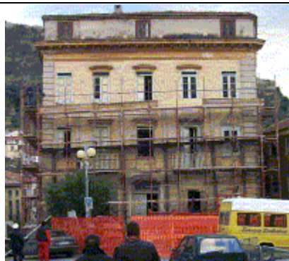
Fig. A4.26 Fuori piombo di circa 8% dell'intero edificio, collegato a dissesto preesistente del terreno per presenza di corona di frana. Il livello del danno preesistente all'edificio è D4, solo leggermente aggravato dal sisma. (Lauria, 1998)
