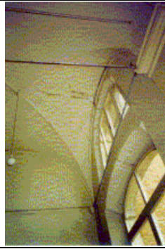
Fig. A4.21 - Lesione longitudinale in chiave di una volta a crociera e distacco dal timpano. Livello del danno alle strutture orizzontali: D2-D3 (Correggio, 1996)
