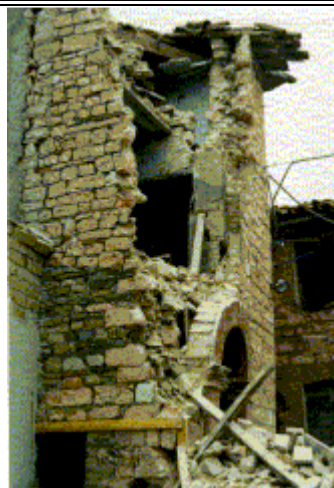
Fig. A4.27 - Crollo parziale di muratura e copertura. Livello del danno alla parete: D4-D5 Livello del danno alla copertura: D4-D5 (Busche, PG, 1998)
